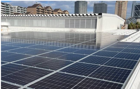
六甲工場の太陽光パネル
