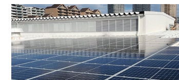
六甲工場の太陽光パネル
