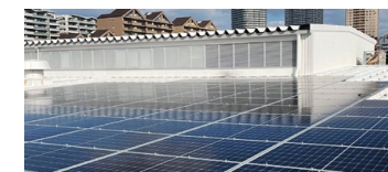
六甲工場の太陽光パネル
