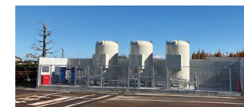
北陸工場のボイラー燃料転換
