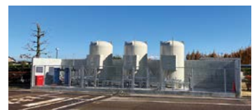
北陸工場のボイラー燃料転換
