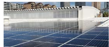
六甲工場の太陽光パネル
