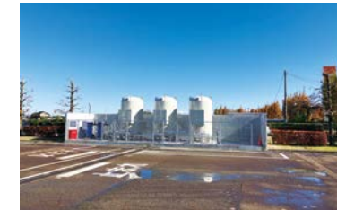
北陸工場のボイラー燃料転換
