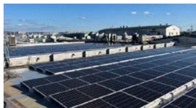
豊橋工場の太陽光発電設備
