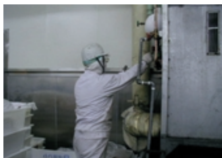
フロンガス漏れの定期検査(北神工場)
