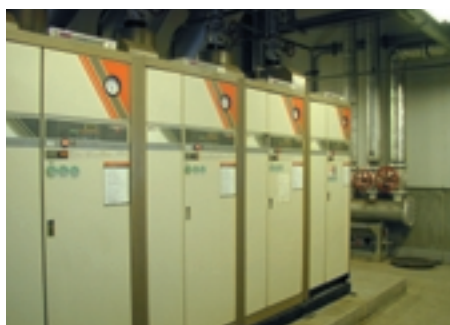
都市ガス燃料の小型ガスボイラー(六甲工場)
