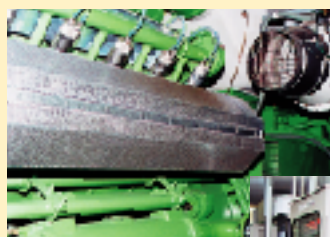
高効率ガスエンジン発電機
