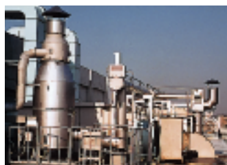
ガス式消煙装置(西宮工場)
