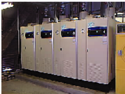
高効率型蒸気ボイラー(六甲工場)
