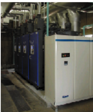
高効率型蒸気ボイラー(東京工場)
