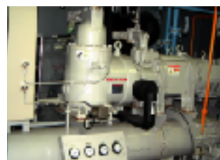
アンモニア冷媒の冷凍設備(九州工場)
