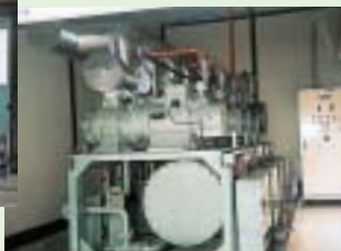
冷凍機（東北工場）
