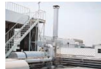
ガス式消煙装置（西宮工場）
