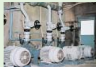
用水ポンプ（西宮工場）
