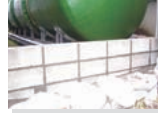
汚水の流出を防止する堰 (サンキョーミート (株) 霧島ミート工場)
