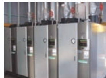
効率の良いボイラー(西宮工場)
