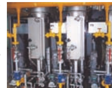
効率の良いボイラー(西宮工場)
