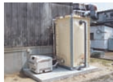
デフロスト水貯水槽(豊橋工場)
