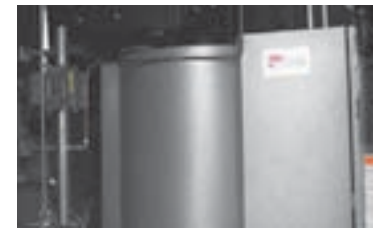
灯油から都市ガスに燃料転換したボイラー（IHミートパッカー（株）東京ミートセンター）
