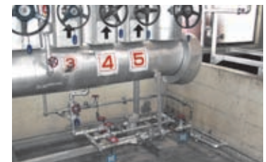
蒸気ヘッダードレン配管ライン(豊橋工場)
