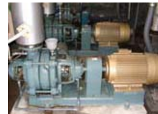
高効率モーター(豊橋工場)
