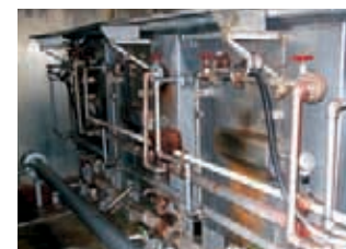
ボイラー槽とドレン水回収配管(豊橋工場)
