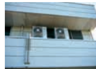
高効率空調設備 (伊藤ハム食品(株)小矢部工場)
