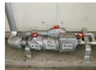
蒸気配管保温ジャケット(豊橋工場)
