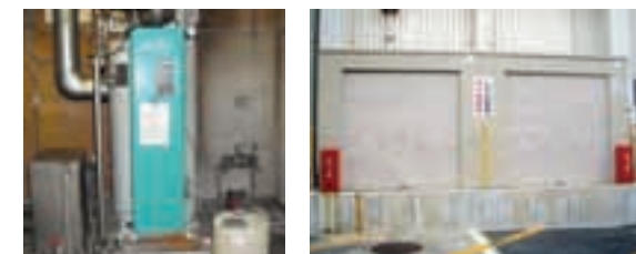
灯油からLPガスに燃料転換したボイラー、LPガス貯蔵設備 （IHミートバッカー（株）宮城ミートセンター）
