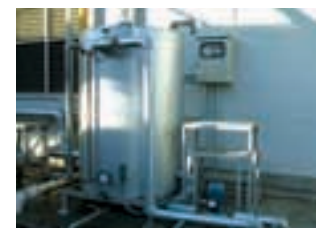
蒸気ドレン水貯留タンク(西宮工場)
