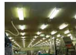
省エネタイプの照明器具 （伊藤ハムデイリー（株）東北工場）
