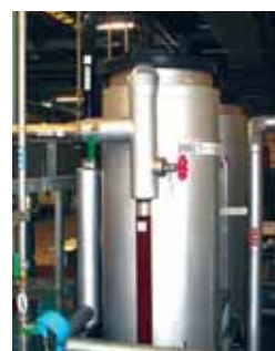
油脂分離回収装置(九州工場)
