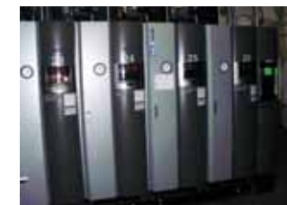
効率の良いボイラー（東京工場）
