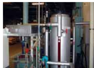
油脂分離回収装置（九州工場）
