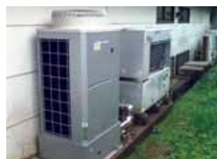
高効率冷凍機（沖縄フレッシュパック（株））
