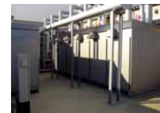
効率の良いボイラー（九州工場）
