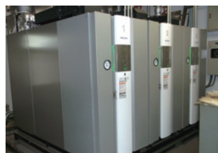
効率の良いボイラー(東京工場)
