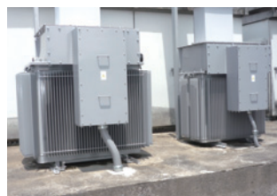
トップランナー方式適用の変圧器 (伊藤ハムデリー(株)東北工場)
