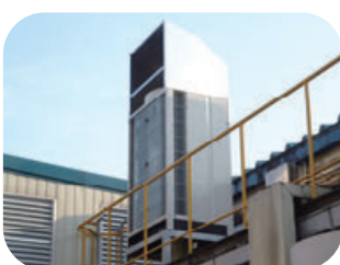
高効率冷凍機 (伊藤ハムデリー(株)東北工場)
