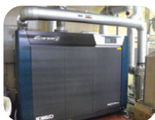
蒸気コンプレッサー集中制御装置 (伊藤ハムウエスト(株)九州工場)
