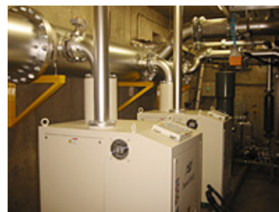
効率の良いブロアー（神戸工場）
