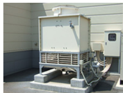
冷却水循環装置（取手工場）
