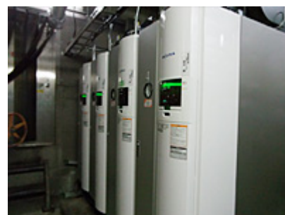
天然ガス焼きボイラー（伊藤ハムデイリー(株)小樽工場）
