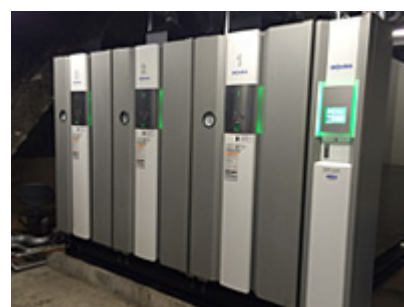
効率の良いボイラー（六甲工場）
