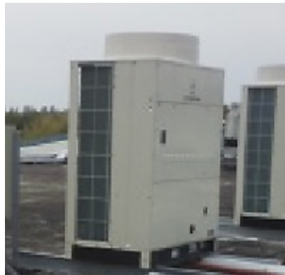
効率の良い冷凍機（豊橋工場）
