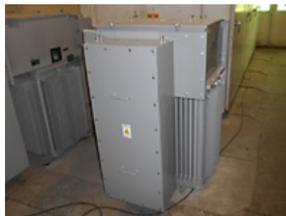
効率の良い変圧器（伊藤ハムデイリー(株)東北工場）
