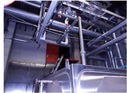
蒸気ドレン水貯水タンク（東京工場）
